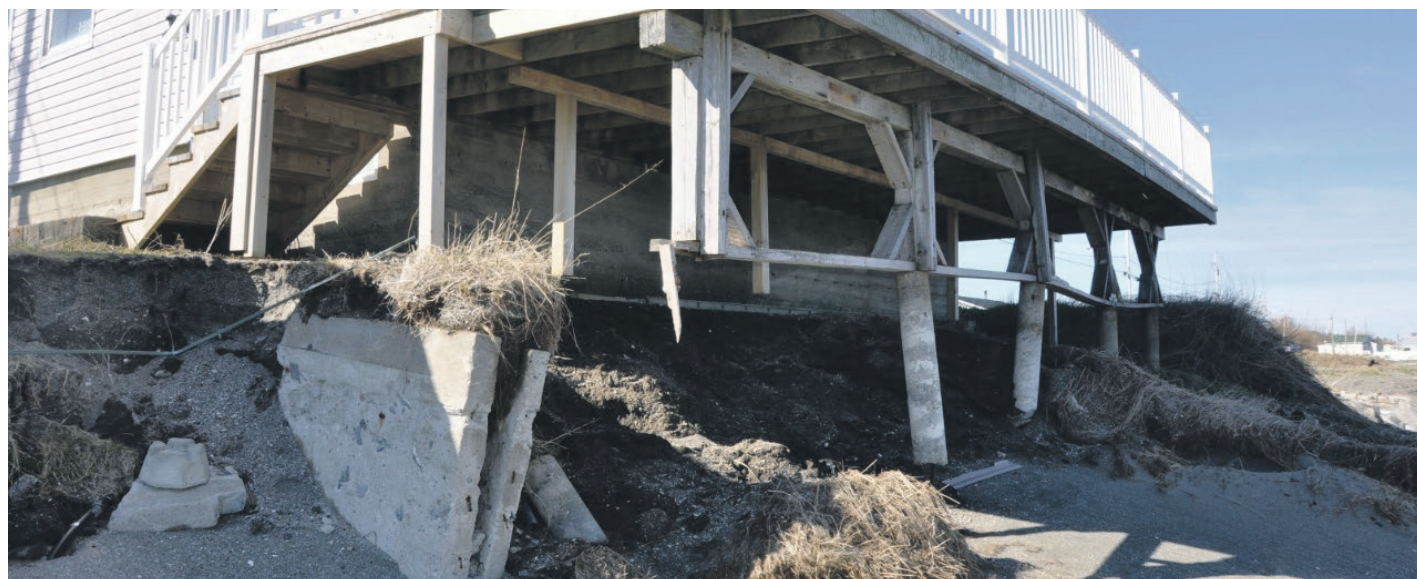
Des épisodes d'érosion sont déjà survenus à Sainte-Anne-des-Monts. Photo Dominique Fortier
